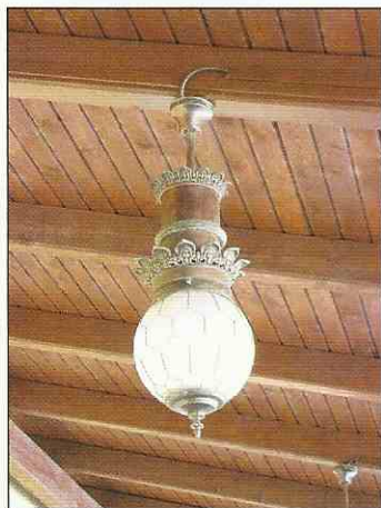
Vác állomás felvételi épületéhez csatlakozó előtető 70 W-os nátriumlámpás lámpateste (1996)
